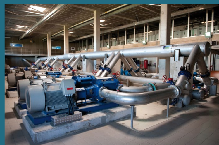
Salle des pompes
