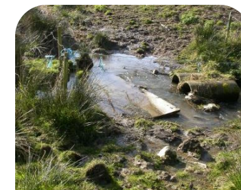
Avant travaux Berges dégradées
