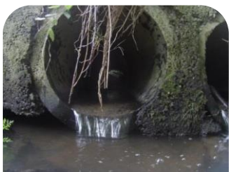
Avant travaux Circulation piscicole limitée
