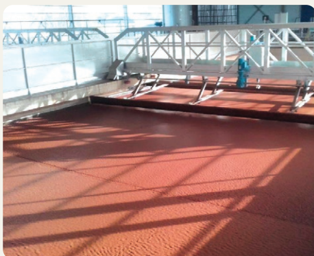
Traitement d'une eau chargée de terre, à l'usine du SMAP
